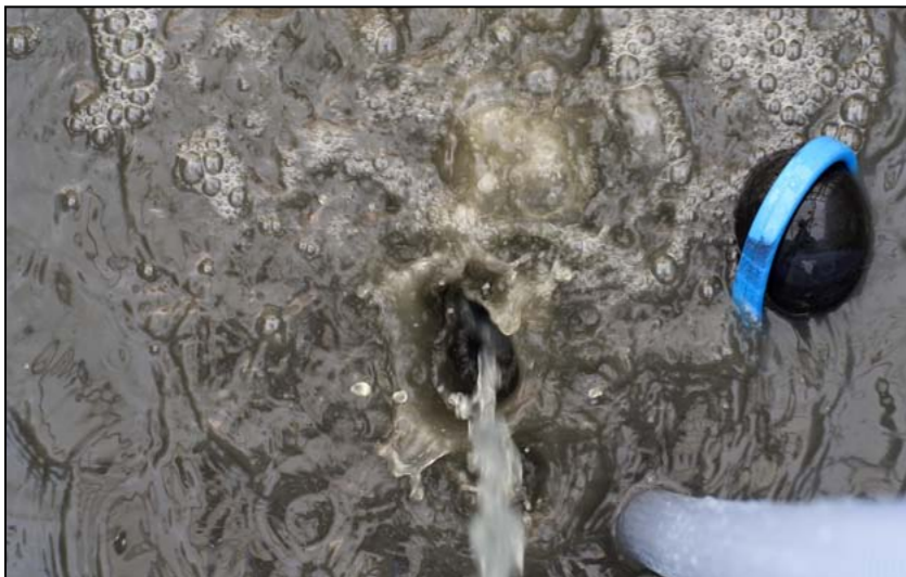
En-kammarbrunn och nivåvipa
